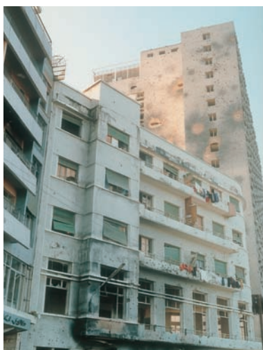
1、2階が市街戦で大破、上層階にパレスチナ難民が住み着くベイルート市内のマンション。後ろのホテルにも砲撃痕（1976年12月）
